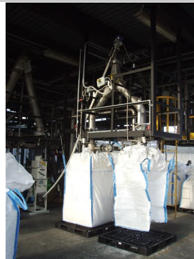
Esempio di realizzazione IMPIANTO CARICO SACCONI con granulato (in ambiente ATEX)
